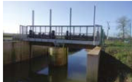
Vanne de la ZEC de la Borre Becque © USAN
